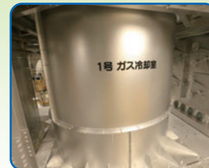
6 ガス冷却室 焼却炉から送られてくる高温の排ガスに水をかけて、急速に冷やすんだ。
