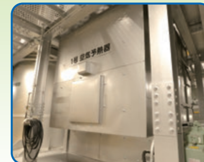
7 空気予熱器 排ガスから熱回収し、燃焼用空気を加熱するとともに温水熱交換器へ温風を送るんだ。
