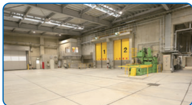
2 プラットホーム みなさんの家から出たごみを収集車がここからごみピットに入れるんだよ。
