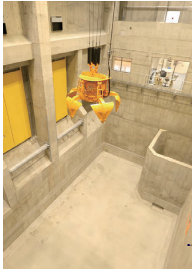
③ ごみピット・ごみクレーン ごみは一旦ごみピットに貯留され、ごみクレーンで攪拌し、均質化した後、ごみ投入ホッパに投入されます。
