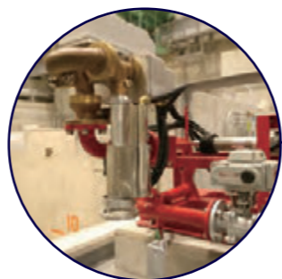
ごみピット放水銃
