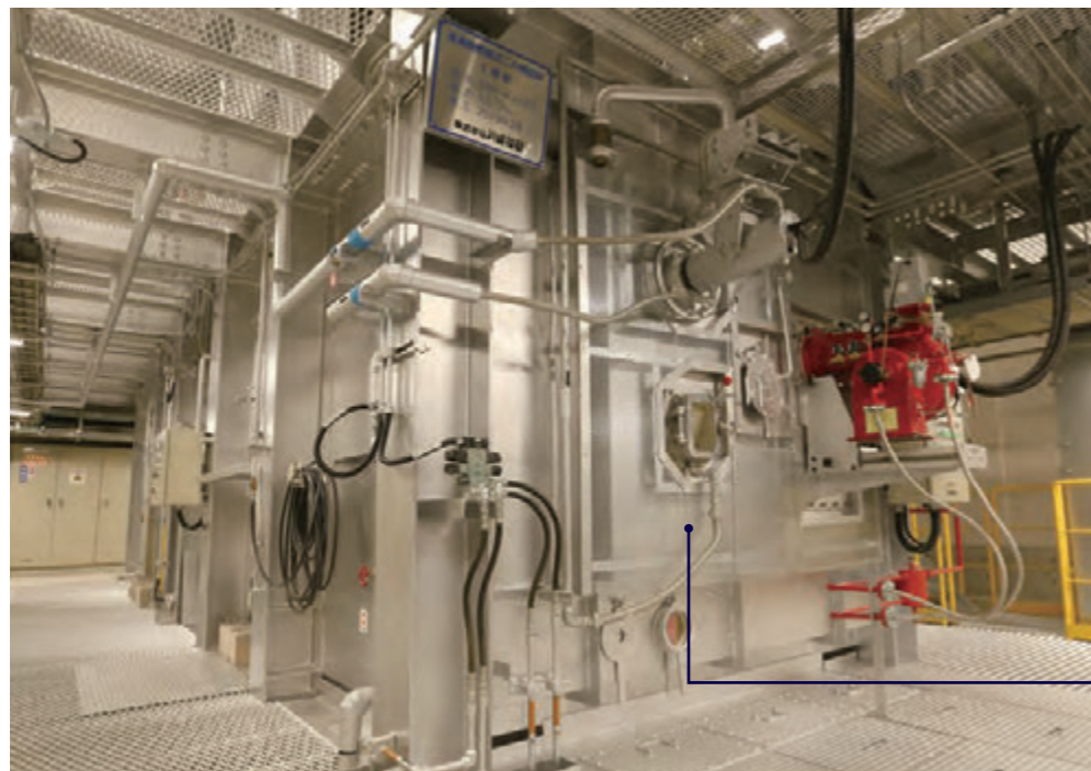
④ 焼却炉 ごみの送り速度と焼却用空気の吹き込み量を調節することで、様々なごみ質に対応し、850℃以上の高温で焼却を行います。
