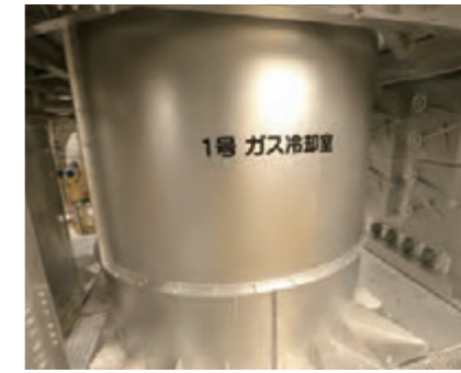
⑥ ガス冷却室 高温の排ガスは、ガス冷却室で急速に冷却されます。
