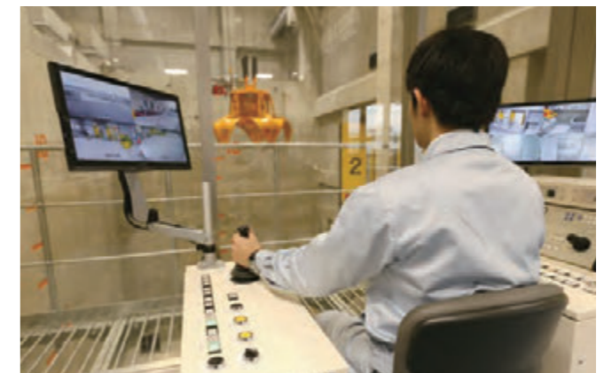
⑫ クレーン運転室 ごみクレーンの操作は、ごみピット側壁面にあるごみクレーン運転室で行います。
