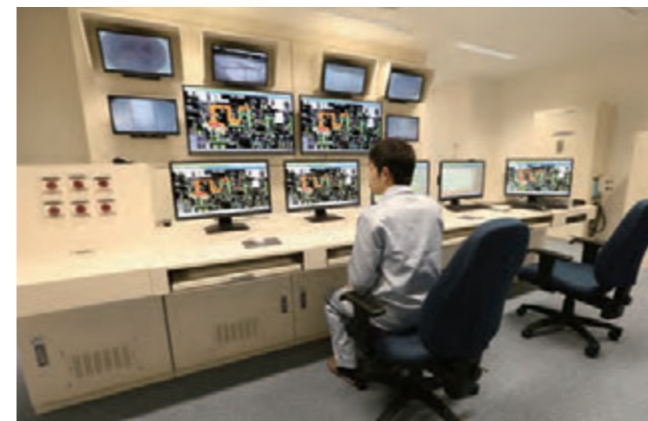
⑪ 中央制御室 施設全体の主要機器をモニターで集中監視し、安全で効率の良い運転制御を行います。
