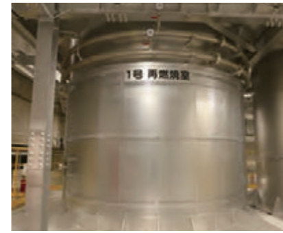
⑤ 再燃焼室 燃焼ガスを完全燃焼させ、ダイオキシン類の発生を抑制します。
